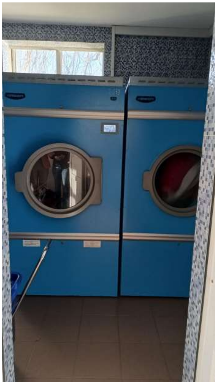
Spălătorie în clădirea CIAPAD 2 deservește toate cele 3 centre
